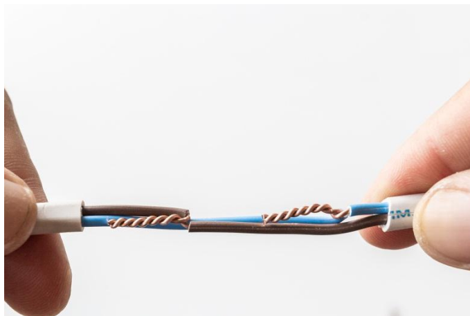
รูปที่ 42 การต่อสายไฟฟ้าแบบสายคู่ สาย VAF (ที่มา นายอภิชาติ ทดราช : 2 มีนาคม 2562)
