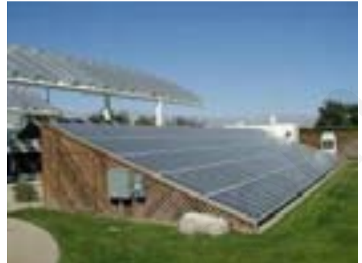
โรงไฟฟ้าพลังงานแสงอาทิตย์
