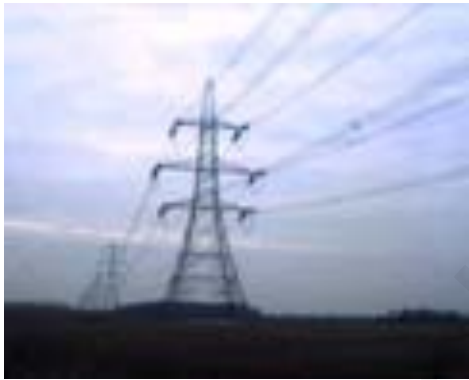
สายส่งไฟฟ้า
